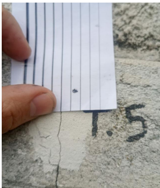
Рисунок 4.2 – Фотофіксація величини розкриття гіпсового маяка на стіні будівлі
