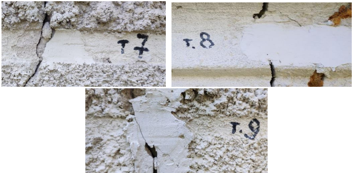
Рисунок 2.9 – Розкриття гіпсових маяків на будівлі №117 у 2022 р.
